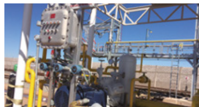
Compresor de transferencia de GLP México - 6HK / 45kW
