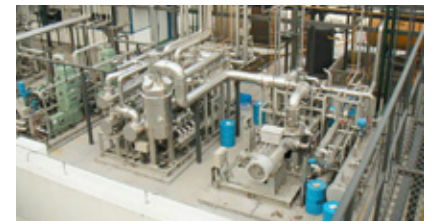
Planta de recuperación / Purificación de NH3 China - 2520SSC / 280kW
