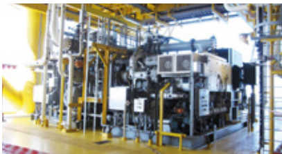
Compresor de recuperación de vapor Vietnam Offshore - 3225MMC / 600kW
